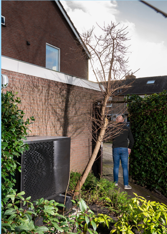
Warmtepomp buitenunit (foto door Reyer Boxem, voor MAKING-CITY)
